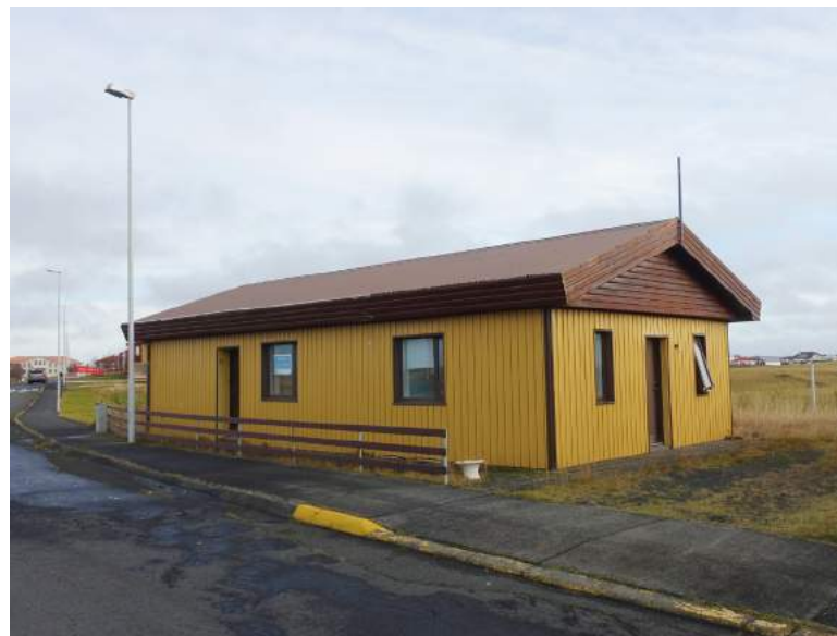
Tjarnargata 12, "Hlíð", byggt 1940. Látblaus bygging, steinsteypt íbúðarhús sem hefur verið klætt panelstáli.
